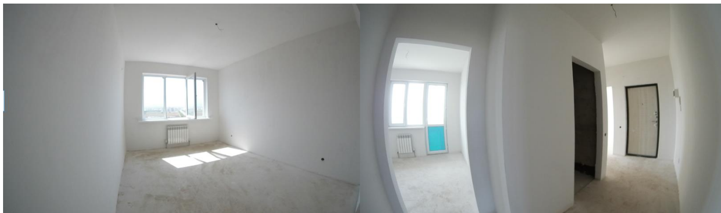
Рисунок Г.2- Внутренняя отделка от застройщика образцового девятиэтажного жилого дома в г. Алматы
