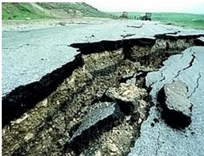
Рисунок 1.15-Трещины, размер которых превышает 1 м
