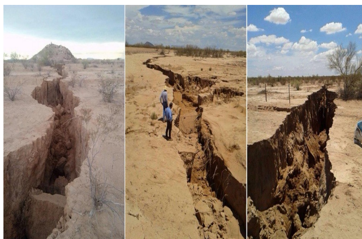
Рисунок 1.7-Трещины на поверхности плотины Буен-Вист, образовавшиеся в результате смещения грунта
