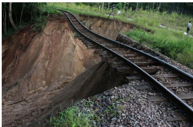
Рисунок 1.9-Деформация грунтов на железнодорожной насыпи при Исфаре-Баткенском землетрясении 1977 г.
