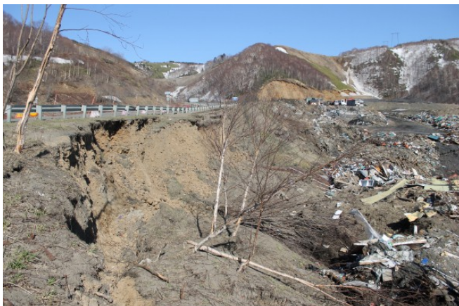
Рисунок 1.17-Обрушение обочины дороги
