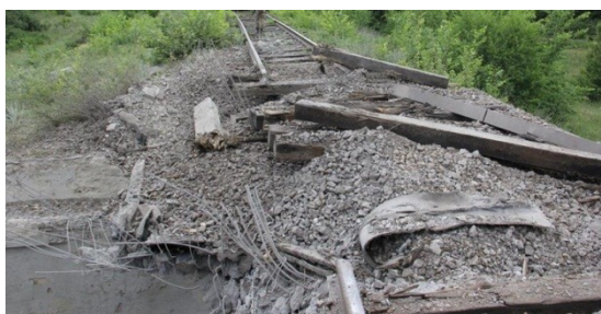
Рисунок 1.2-Смещение железнодорожной насыпи, вызвавшее перевертывание рельсов и шпал
