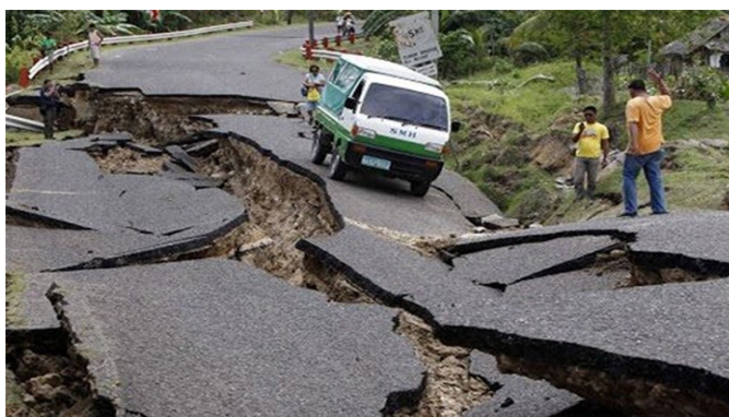
Рисунок 1.11-Разрушение магистральной дороги в поселке Джирон в результате оседания почвы
