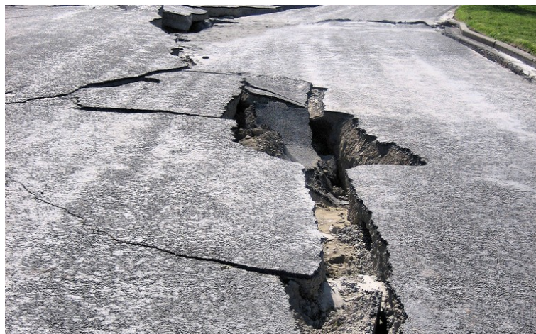
Рисунок 1.5-Фрагмент образования трещин на автостраде Хокурику – До в результате смещения дорожных насыпей
