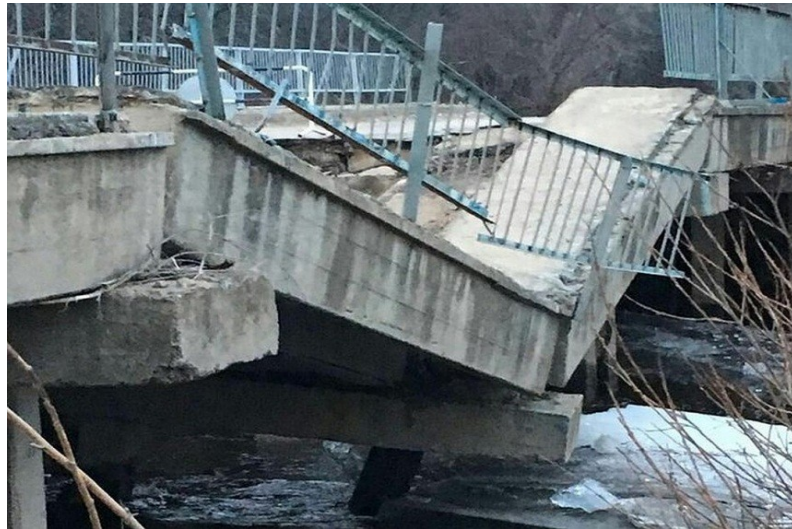
Рисунок 1.4-Осадка грунта на подходе к мосту
