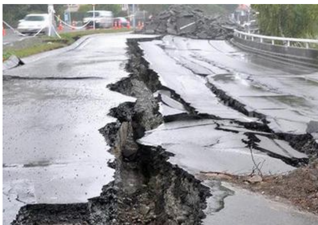
Рисунок 1.18-Повреждение магистральной дороги
