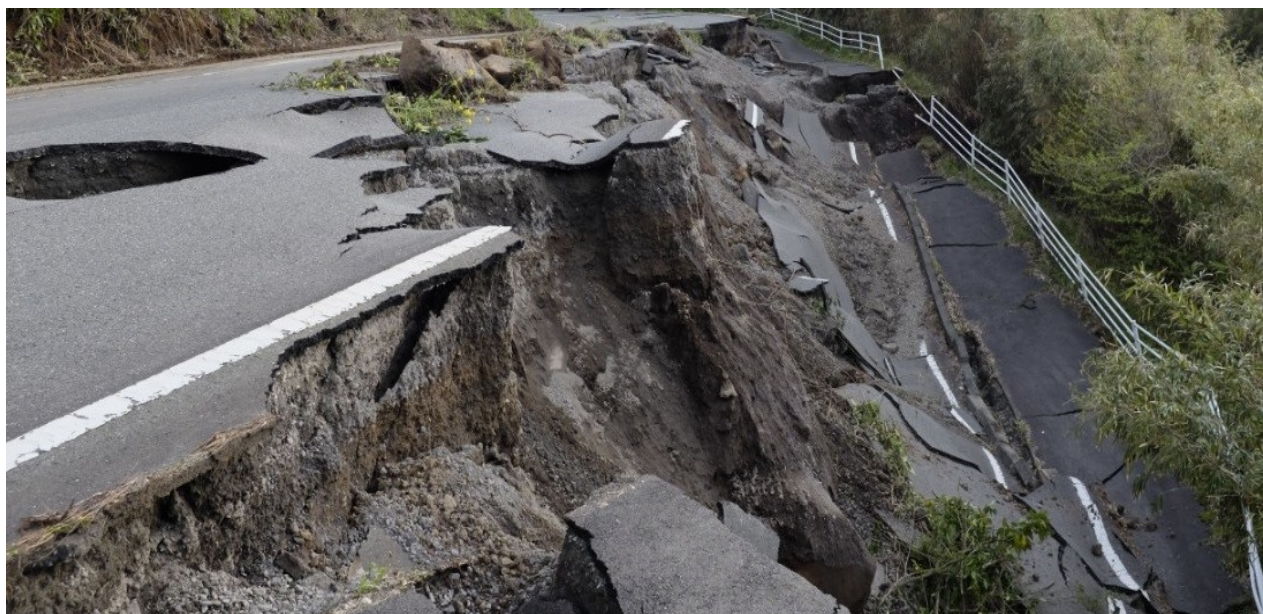
Рисунок 1.1-Обрушение дорожной насыпи во время землетрясений
