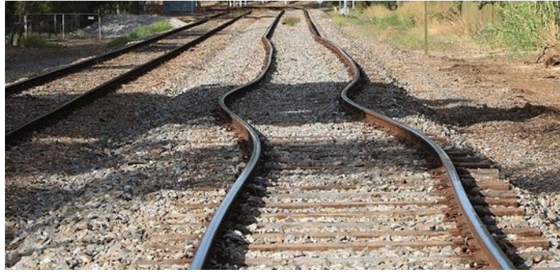
Рисунок 1.3-Искривление железно дорожного пути
