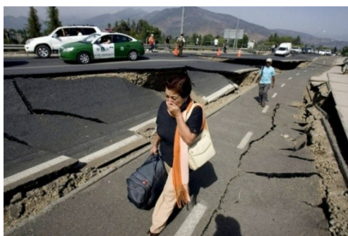
Рисунок 1.10-Повреждение магистральной дороги в результате смещения почвы
