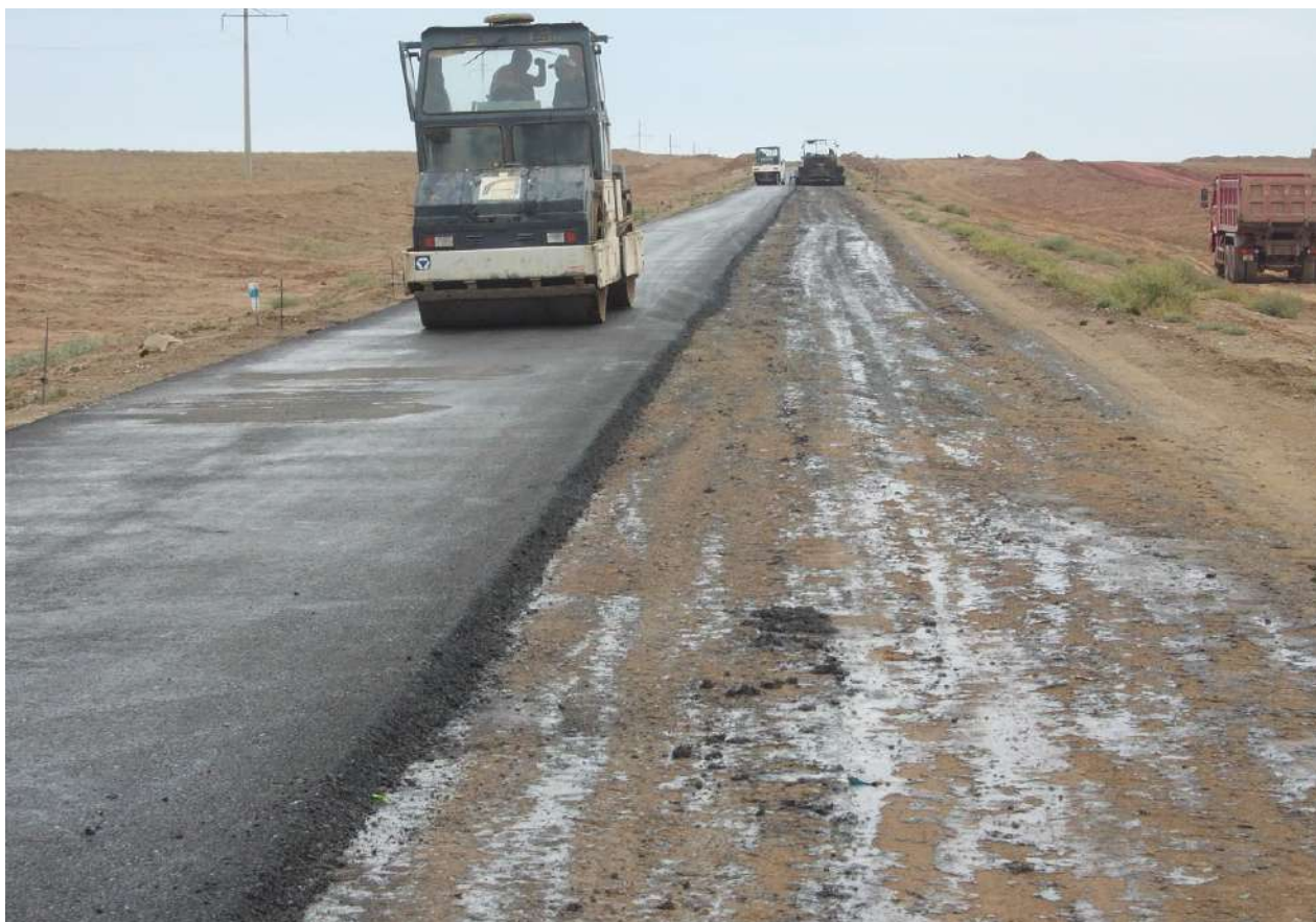
Рисунок 5.4 - Уплотнение уложенного слоя асфальтобетонного покрытия сверх укатанных наноструктурированных бетонов из шлакового белитового вяжущего основания автомобильной дороги «Шиели-Тойконур»
