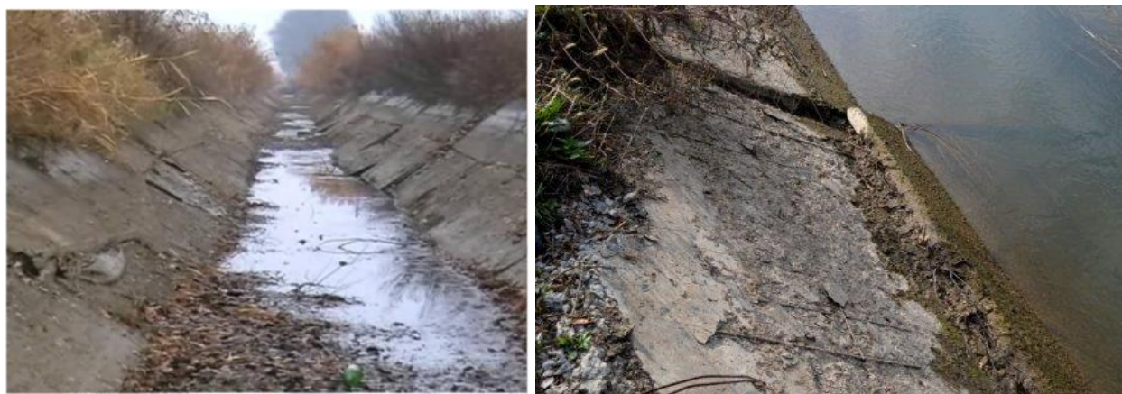
Рисунок 2 – Поврежденный участок бетонопленочной облицовки канала
